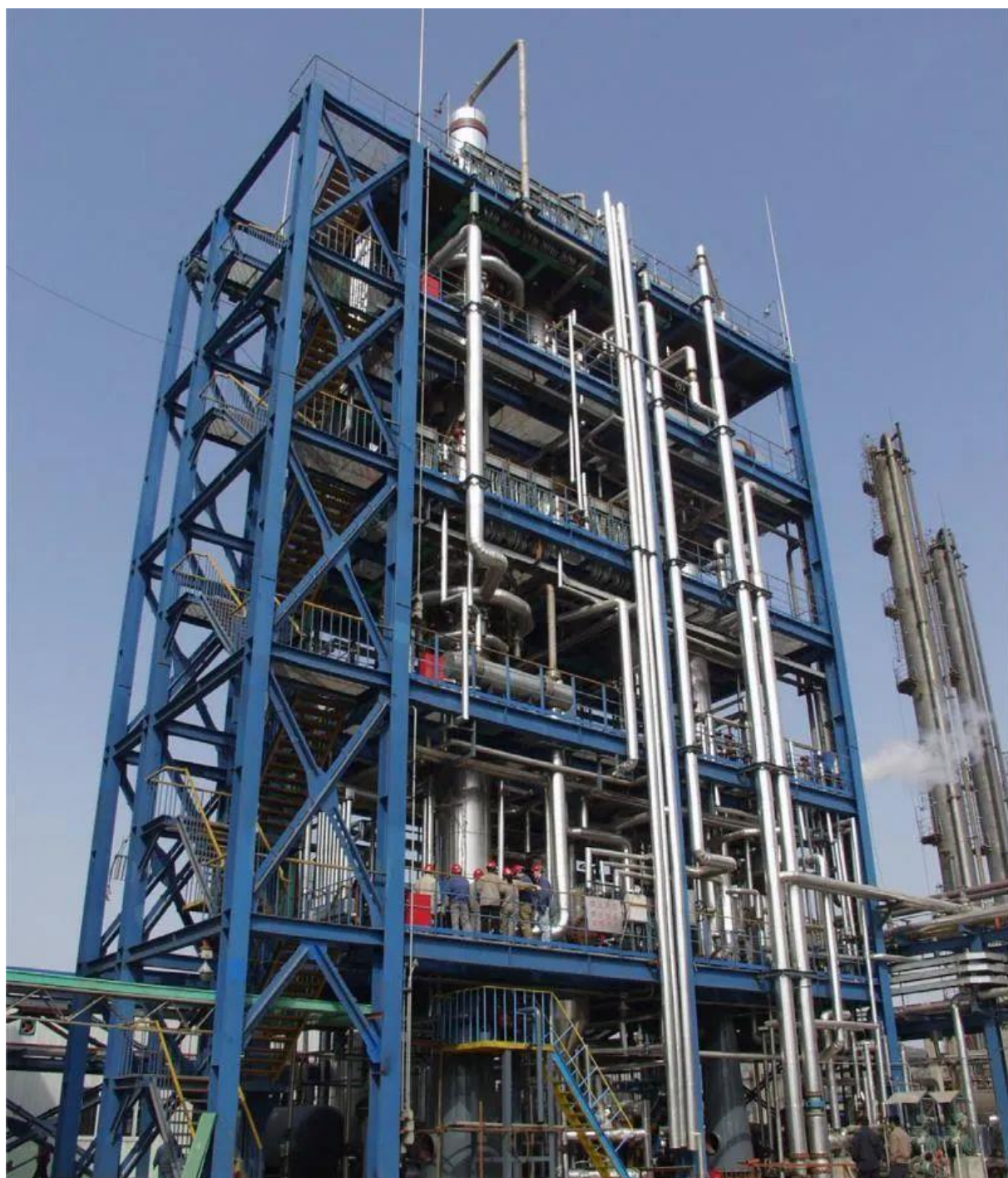
图 3 产油能力 5000t/a 的煤间接液化(合成气费托合成)中试装置
