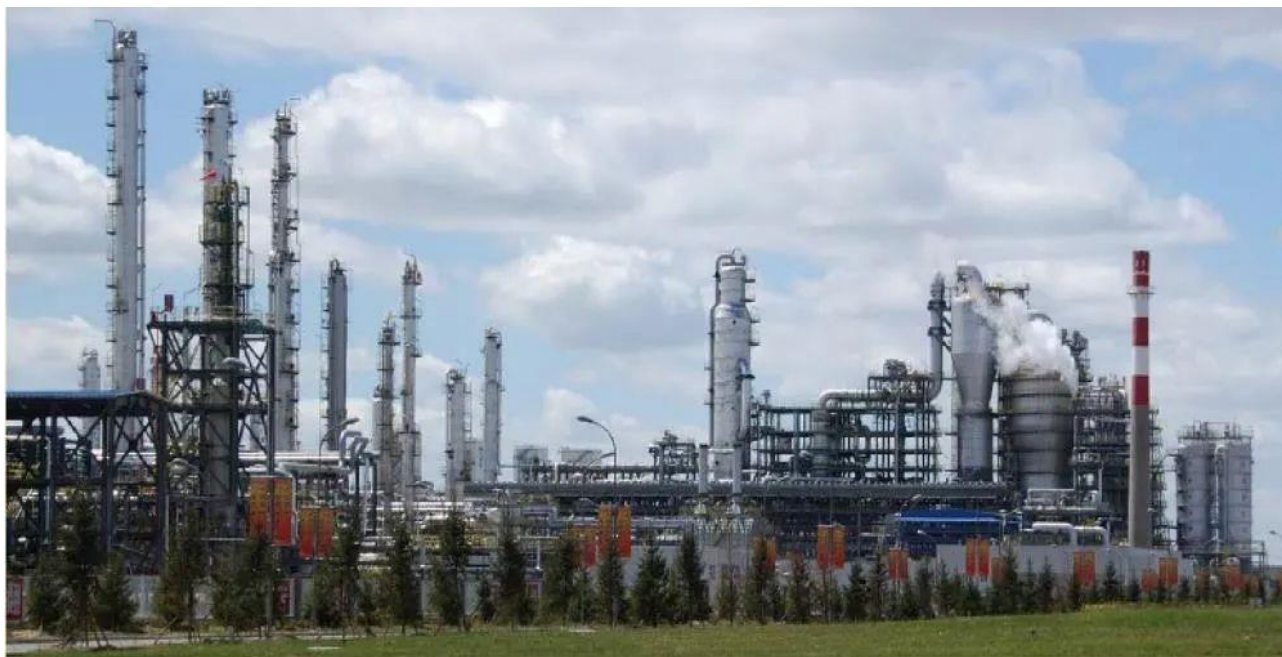
图 24 神华包头煤制烯烃工业化示范项目甲醇制烯烃(DMT0)的主要装置
