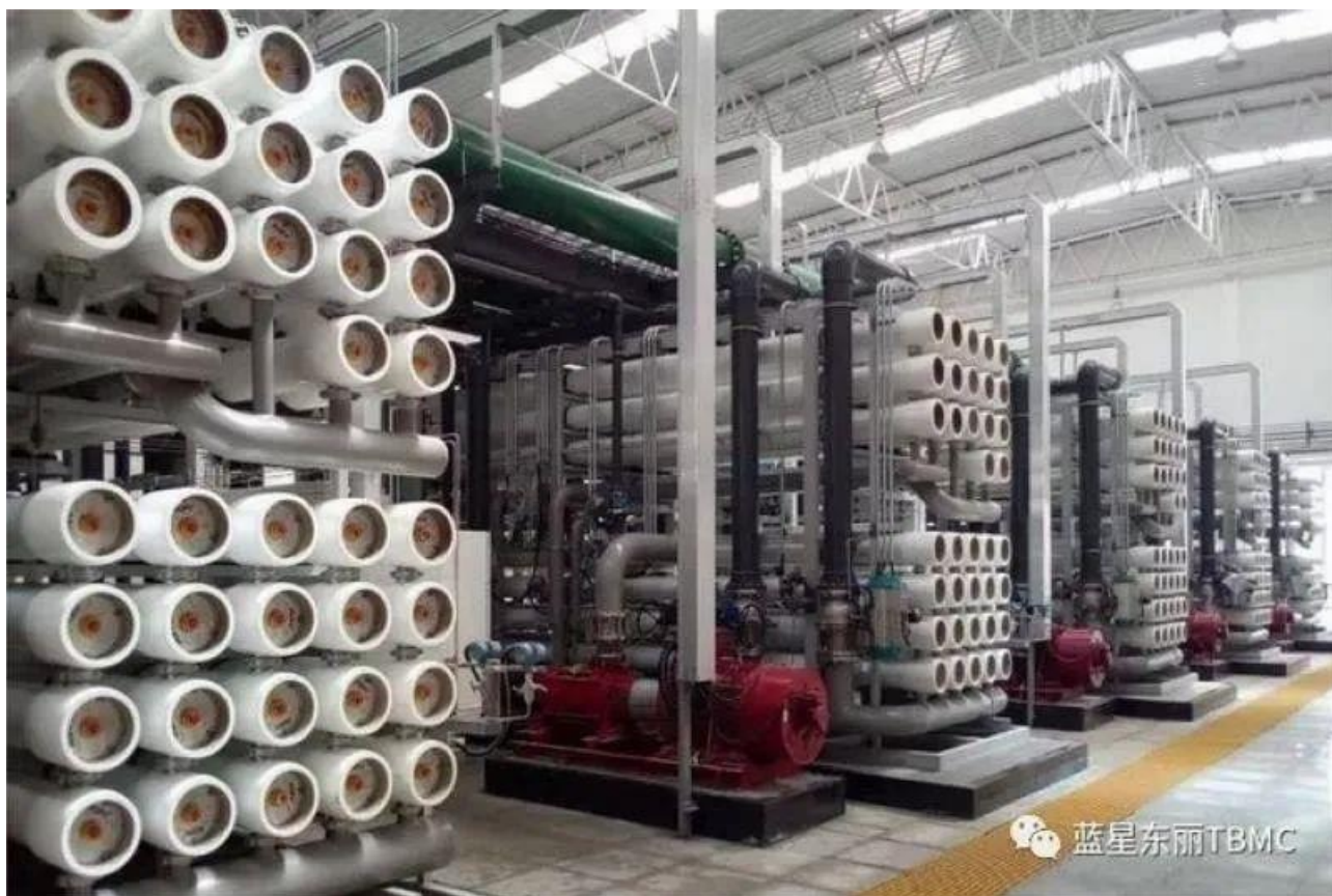
图 27 中天合创矿井水深度处理资源化利用工业化示范项目的反渗透脱盐系统
