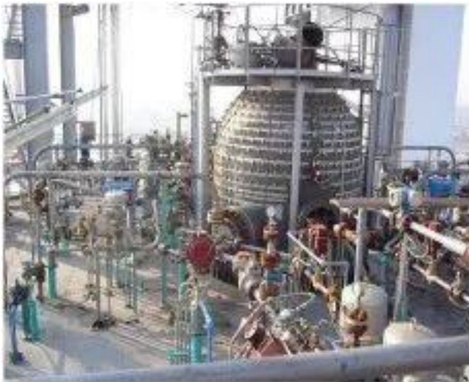
图 2 原料煤处理能力 750t/d 的多喷嘴水煤浆气流床加压气化中试装置
